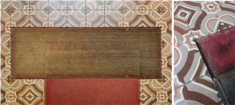
Figura 85 - Segunda parte da Ficha de Identificação de Danos 06/13
