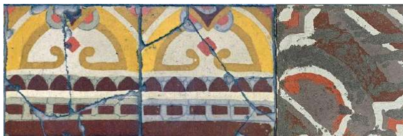
Figura 71 - Estado atual de conservação dos ladrilhos do Paço
